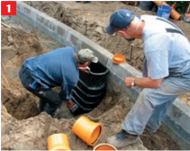
1 Ablaufkörper auf Sauberkeitsschicht versetzen, Oberkante Ablauf=13 cm* unter GOK, Fundamentbeton C 12/15 gem. DIN EN 206-1, d/b=20 cm bis zur ersten Querrippe, Ablaufstutzen ausreichend überdecken
