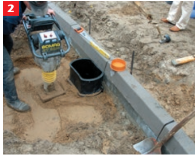
2 Verfüllen nach DIN EN 1610 mit seitlichem Verfüllmaterial nach DIN 18196 (Sand-Kies-Gemisch, Rundkornmaterial 0–32 mm oder gebrochenes Material Korngröße 0–16 mm oder Split), letzte Querrippe muss ca. 3 cm überdeckt sein
