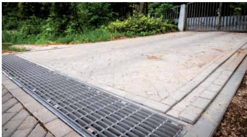
ExoDrain voorzien RVS maastrooster bij toegang begraafplaats Rheden.
