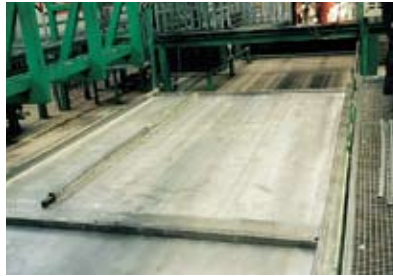
Aftekenen resp. bepalen van de positie van het kozijn in de mal.
