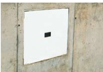
De montageplaten tot het einde van de ruwe bouwphase laten zitten om de kozijnkantstukken en inzetramen te beschermen.
