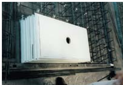
Nadat de wapening is aangebracht wordt, voordat het beton gestort wordt, het door een montageplaat aan de buitenkant beschermde, kozijnkantstuk opgezet. Extra aandrukken is in de regel niet nodig.
